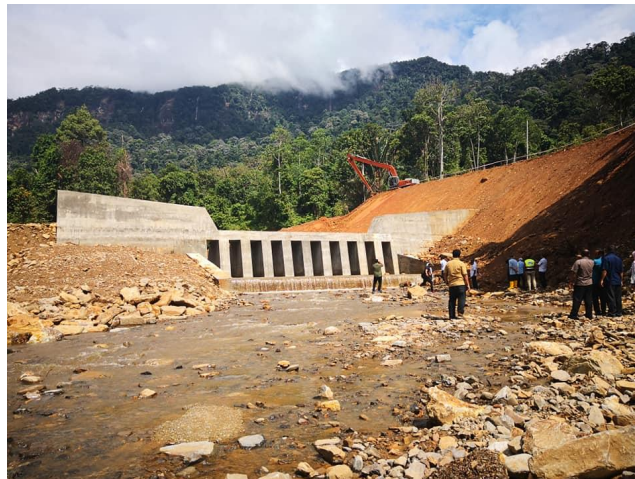
Rajah 5.3.1.ii Contoh Empangan Sabo di Yan Kedah
