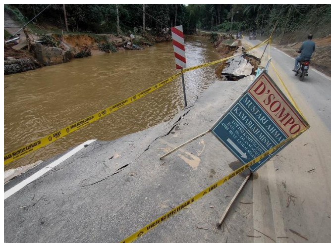
Rajah 4.2.2.iv Jalan yang terhakis kesan daripada fenomena kepala air.
