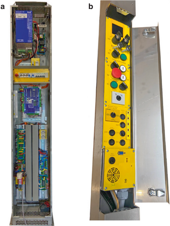
Fig. 7.5 a) Control system for a lift without machine room b) Service panel (Source: KW Aufzugstechnik GmbH, Oberursel, Germany) (Source: KW Aufzugstechnik GmbH, Oberursel, Germany)
