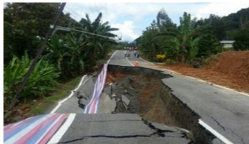
Rajah 1.2: Kegagalan jalan raya di Matang
